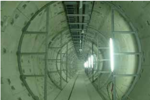
345KV 電纜洞道
