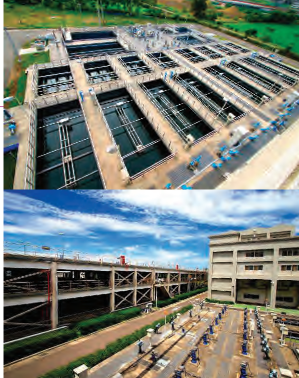
竹南園區污水處理廠主要操作單元
