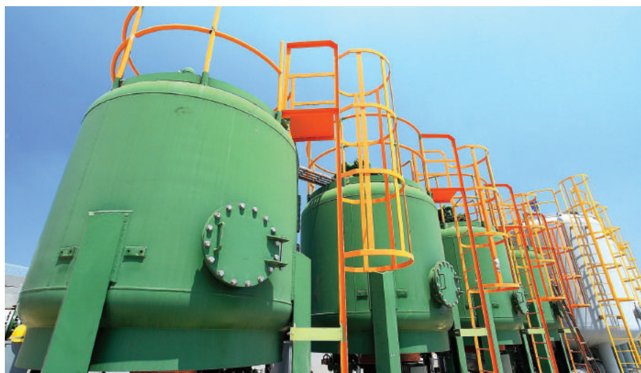
銅鑼科學園區污水處理廠
