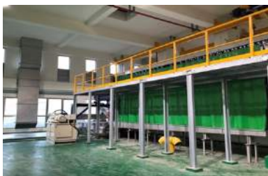
新設板框式脫水機房
