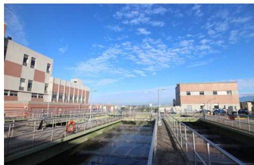
龍潭園區污水處理廠
