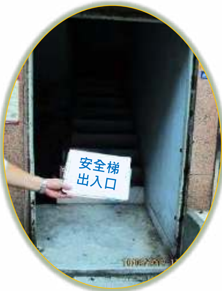
安全梯之出入口無防火門扇
