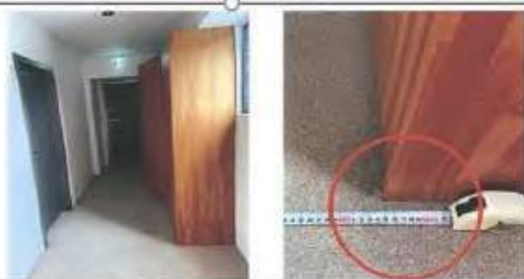
現場設置固定櫃體，走廊寬度為 115cm<120cm
