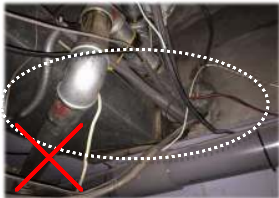
管道未施作防火填塞照片
