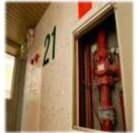
管道間維修門
