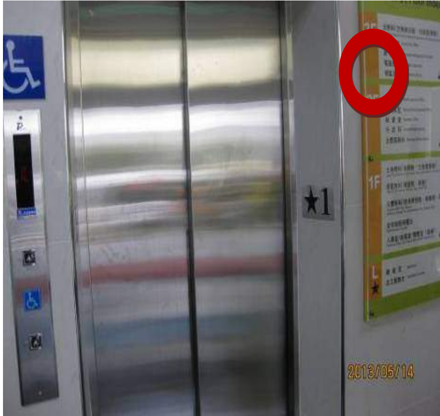
以無障礙標誌標示無障礙升降機案例
