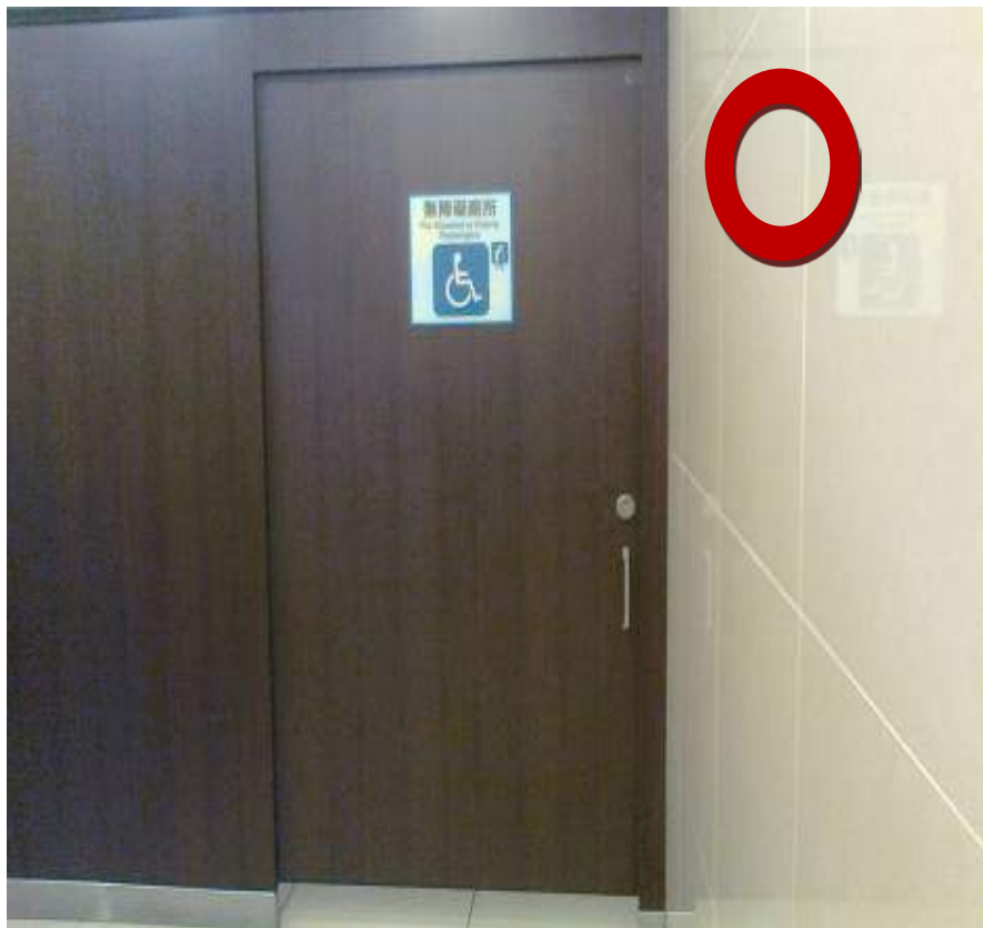
無障礙廁所前牆壁或門上應設置無障礙標誌
