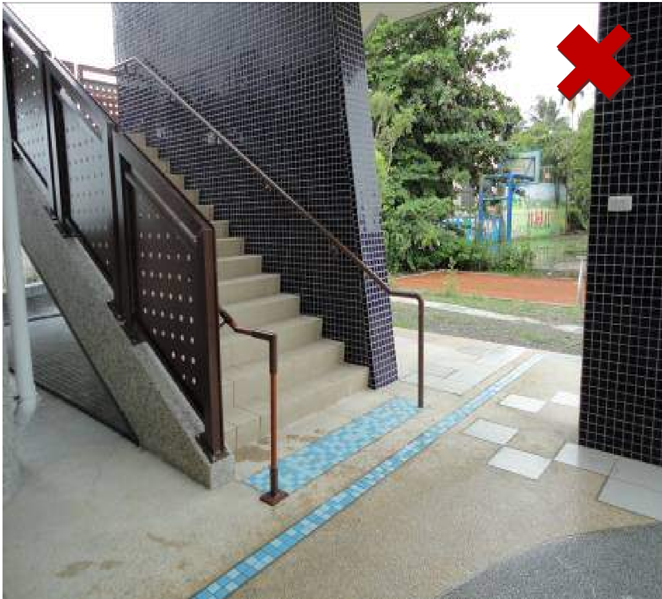
扶手水平延伸不得突出走道上，以防止碰撞危險。
