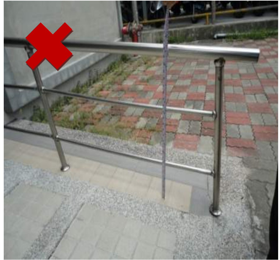
扶手端部未做防勾撞處理，視障者易撞擊突出物。
