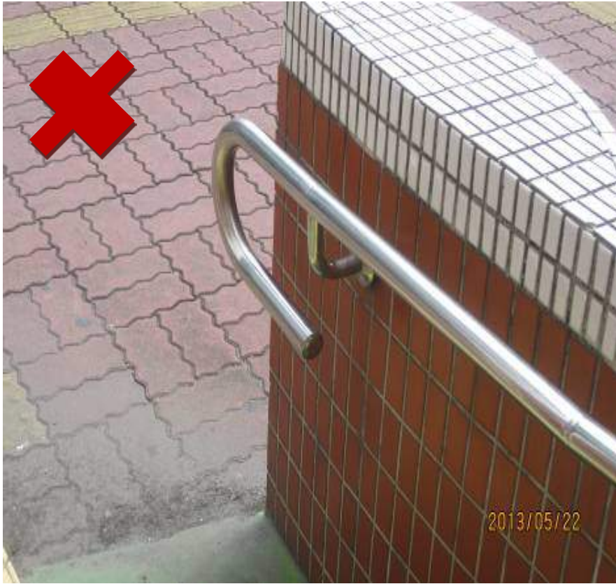
扶手端部未做防勾撞處理，視障者易勾住衣物。
