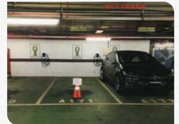
圖 7-3 停車場內設置電動車充電樁
