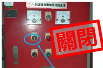
B2室內消防栓設備消防泵浦
