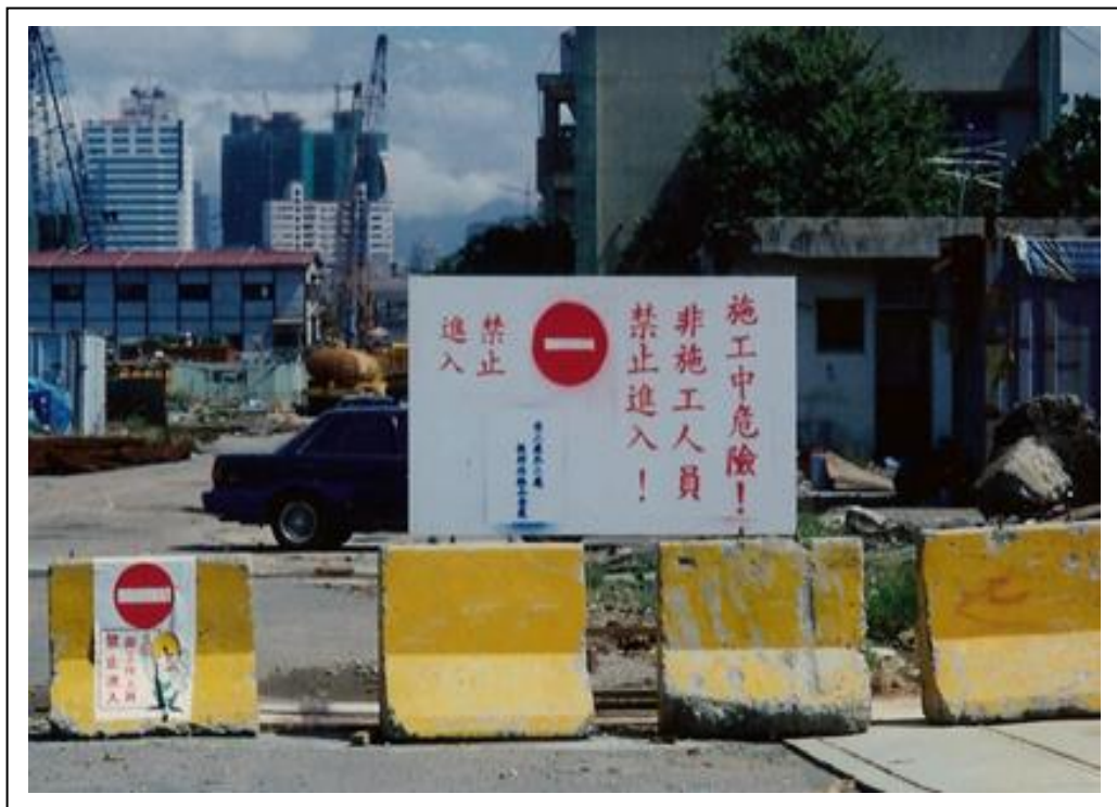
照片 04 露天開挖工作場所，禁止非施工人員進入警告標示
