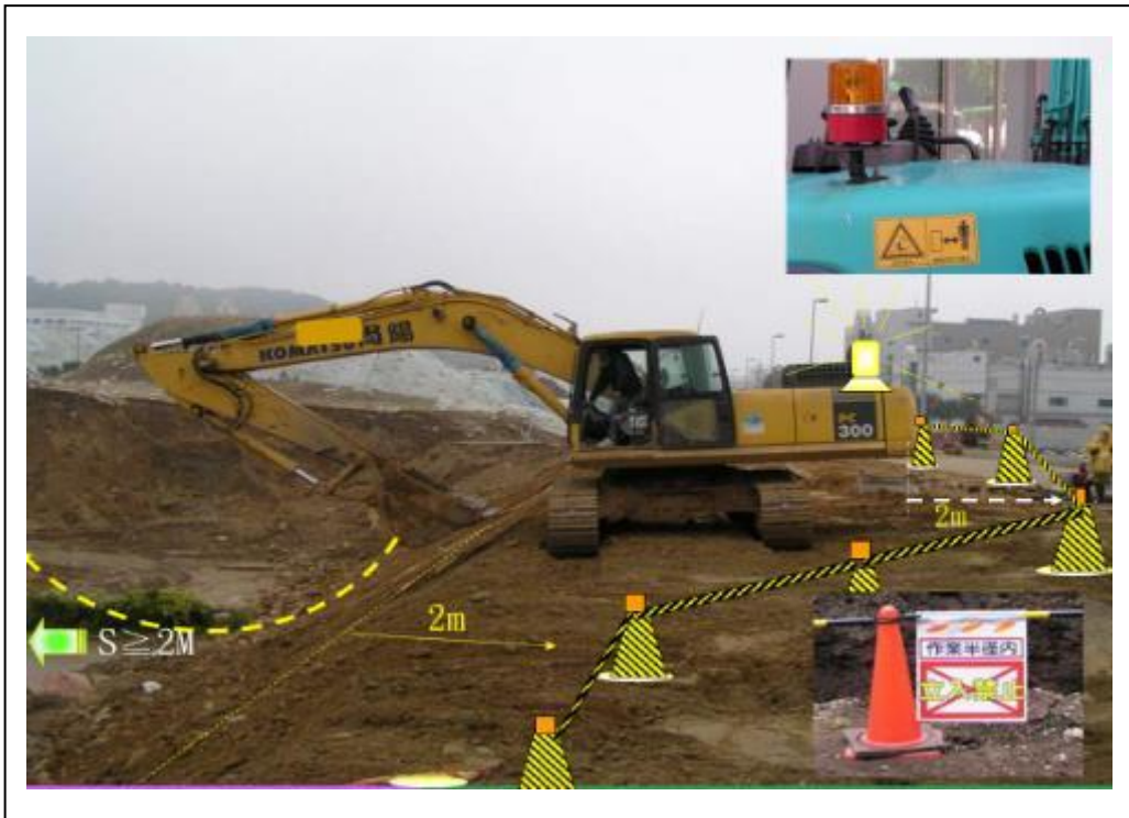
照片 10 嚴禁操作人員以外之勞工進入營建用機械之操作半徑範圍內
